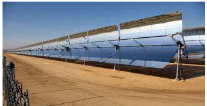
Объект: солнечная электростанция Shagaya Месторасположение: Марокко Мощность: 50 МВт
